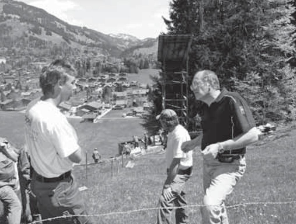
Der Abriss des Springrichterturms der ehemaligen Mattenschanze war eines der besonderen Projekte für die GST-Werkgruppe.
